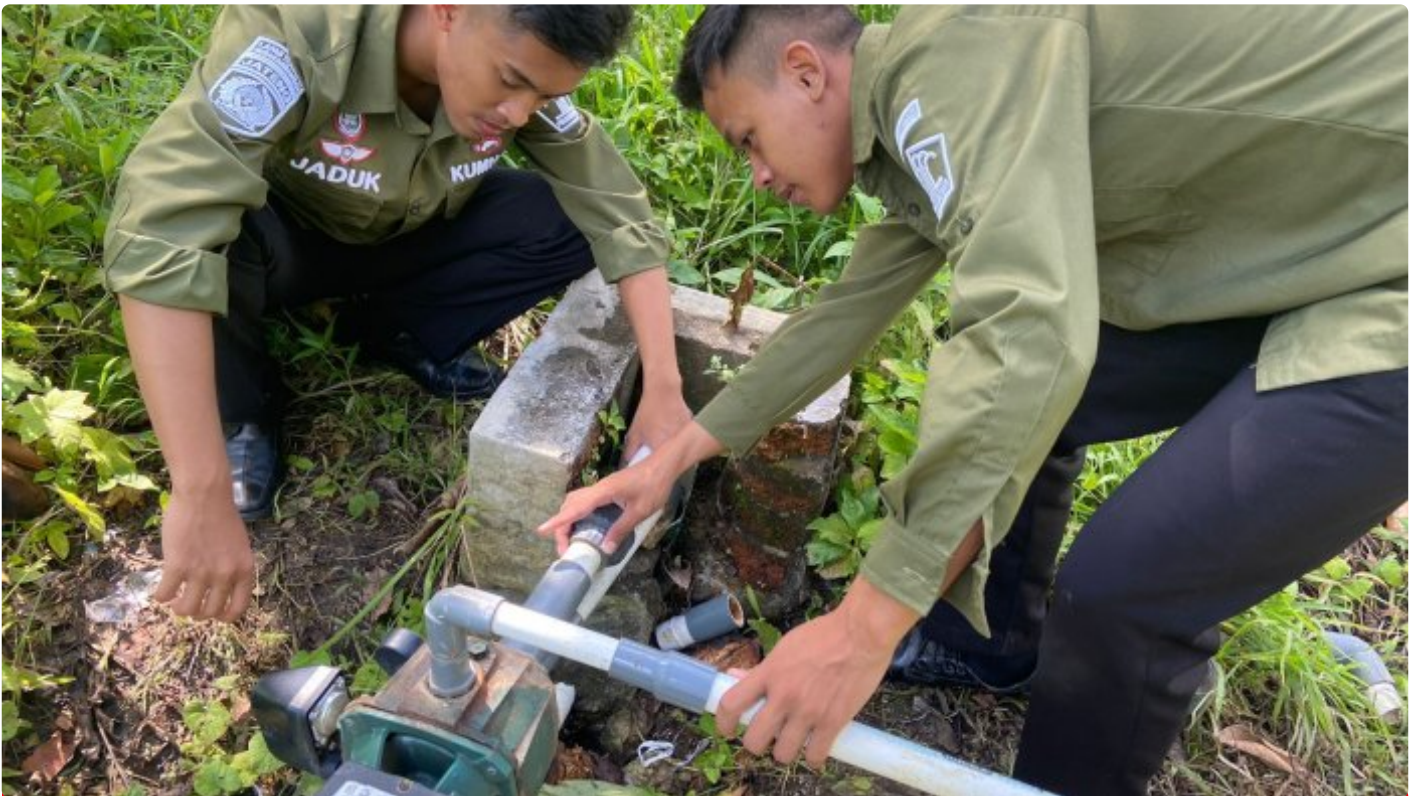
Petugas Lakukan Pengecekan Panel Meter Listrik dan Air
